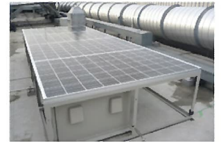
約1kWの太陽光パネル
