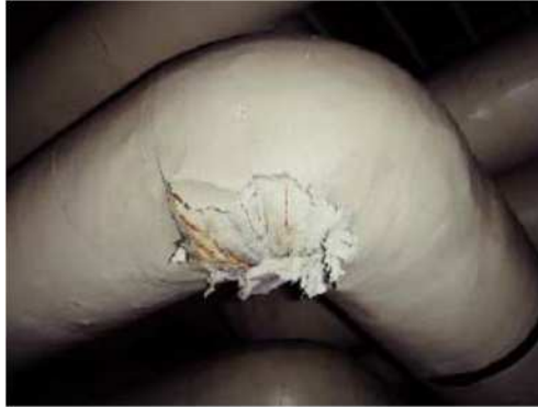
(写真4) 配管エルボ保温材
