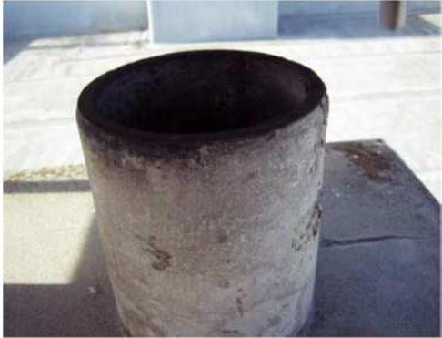
(写真3) 煙突断熱材
