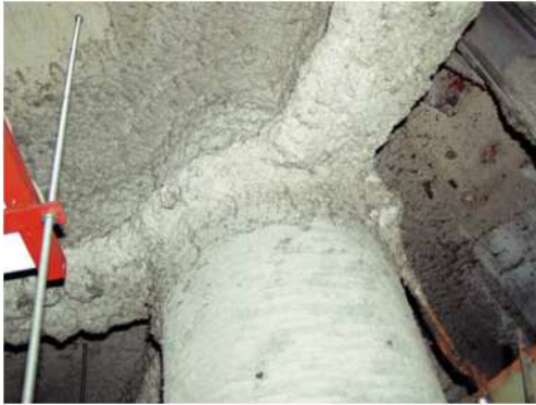
(写真1) 吹付け石綿
