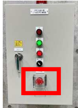
扉横の制御盤
