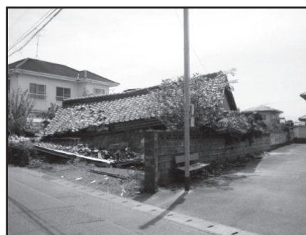
【熊本市 損壊家屋】
