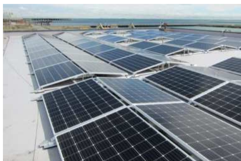
< 太陽光発電設備 >
