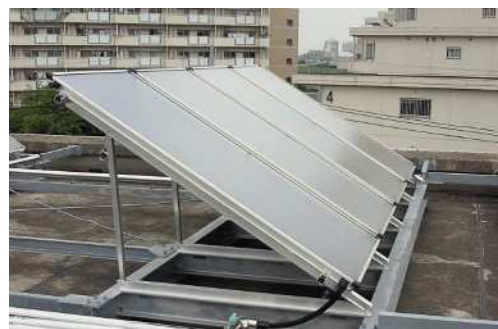
< 太陽熱利用設備 >
