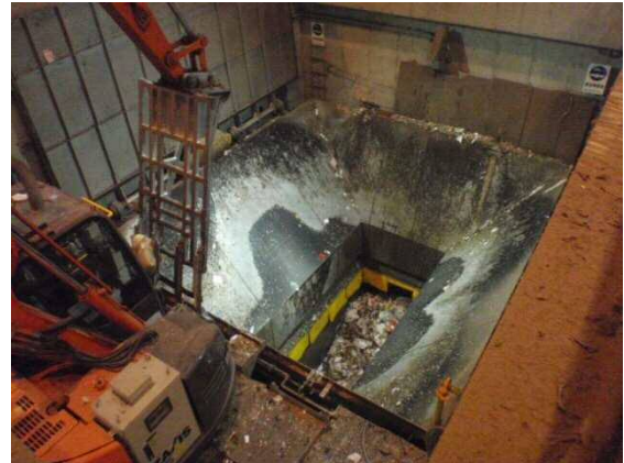
ごみ積替え設備
