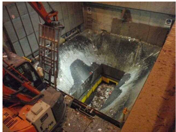
ごみ積替え設備
