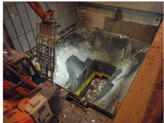
ごみ積替え設備
