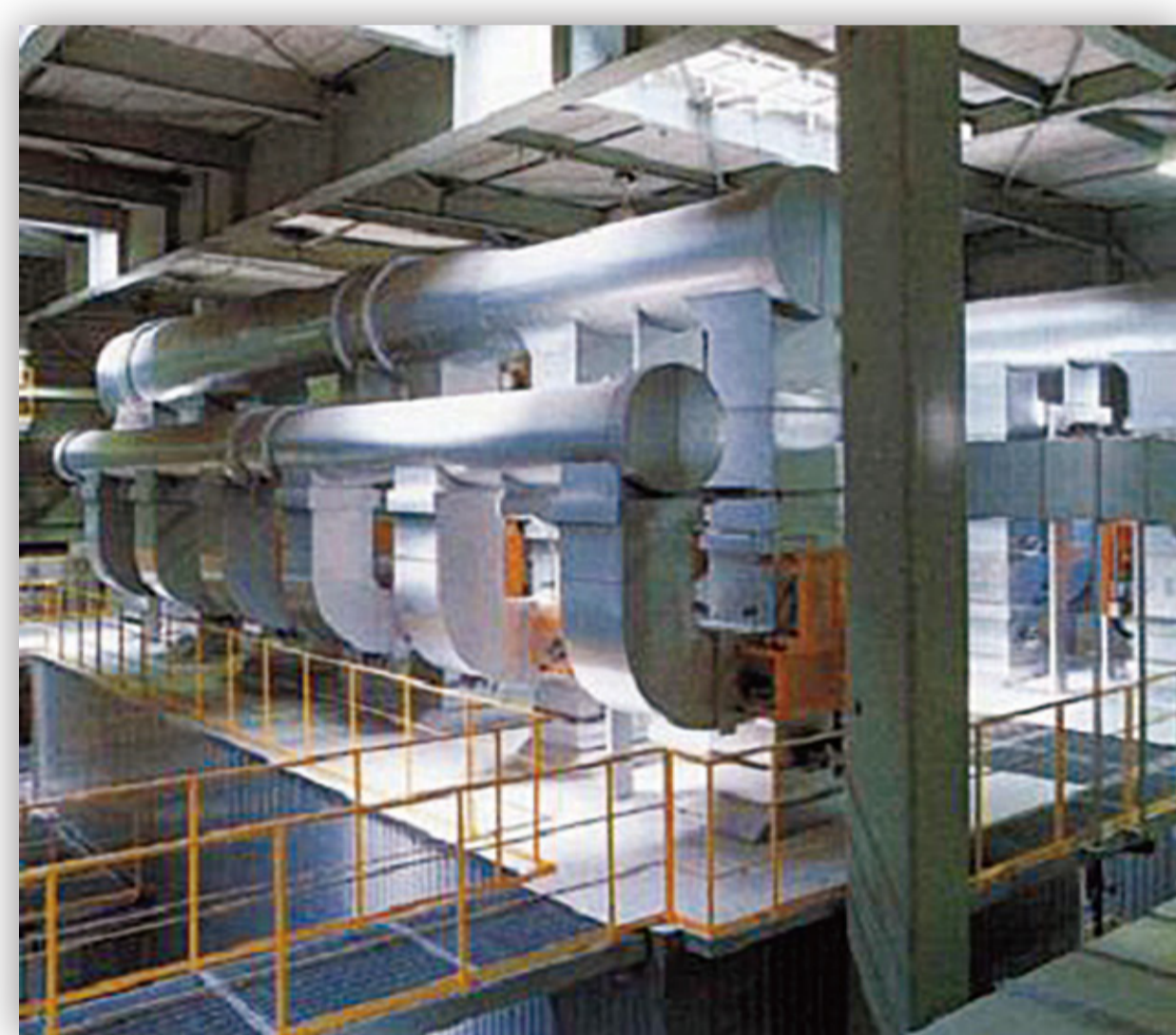
排煙処理装置
