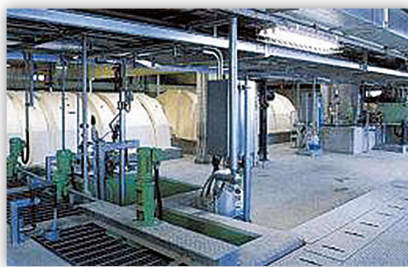
排水処理装置
