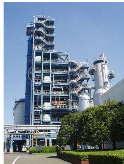
水素製造プラント （レゾナック川崎事業所）
