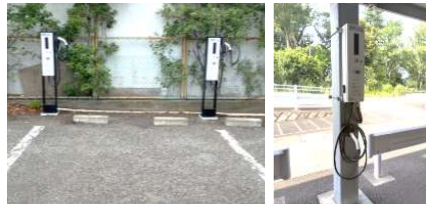
設置した充電設備
