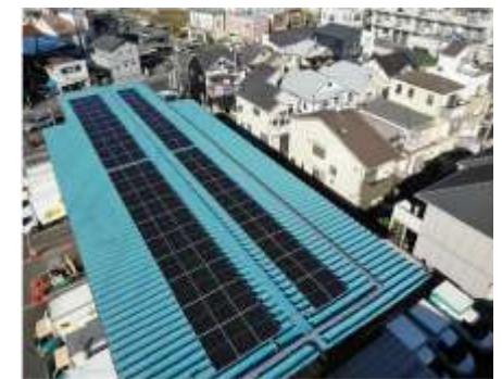
太陽光発電設備（ヤマト運輸）
