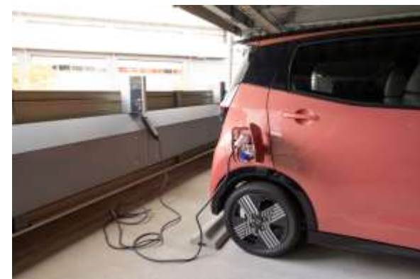
マンションにおける充電設備
