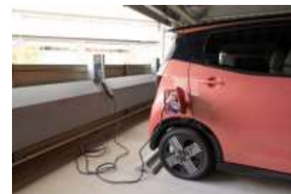
マンションにおける充電設備
