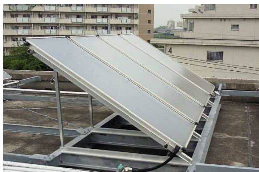
< 太陽熱利用設備 >
