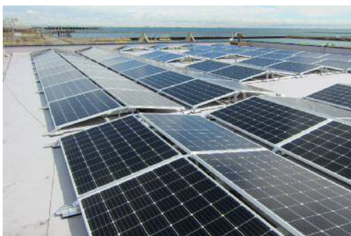
< 太陽光発電設備 >
