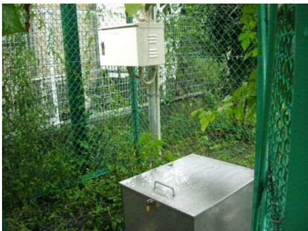
地下水位観測所の水位計
