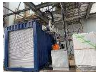
▲ CO 2 分離回収 実証試験設備
