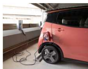
▲マンションにおける充電設備
