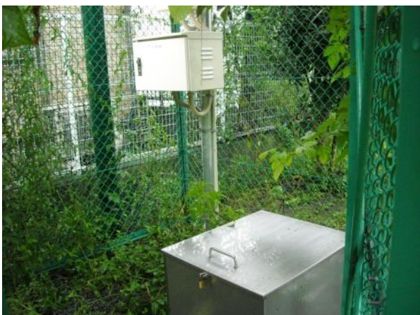
地下水位観測所の水位計
