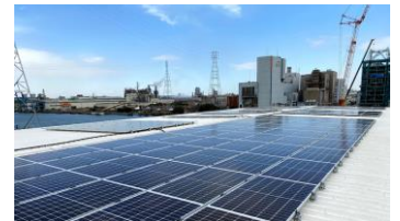
太陽光パネル
