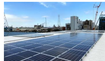
太陽光パネル
