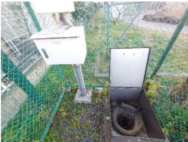
地下水位観測所の水位計
