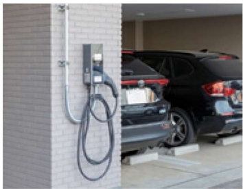
共用スペースに設置された充電器。コンパクトで邪魔にならない
