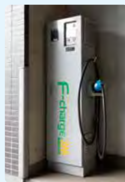
設置されているのはまだ珍しいマンション給電システム。災害に備えた活用が期待される
