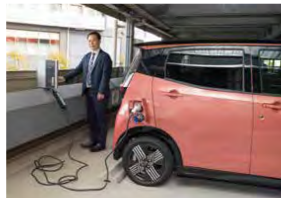
2階建ての立体駐車場の2階に設置された充電器
