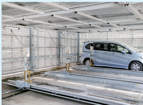
駐車場スペースに設置された充電器。駐車場代に定額料金を追加して利用する仕組みになっている
