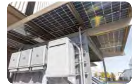
太陽光で発電した電気はステーション横の蓄電機へ。災害時には給電システムにもなる。
