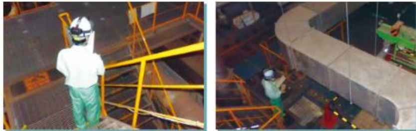
資源化処理施設 浮島処理センター様
