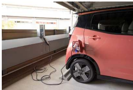
マンションにおける充電設備
