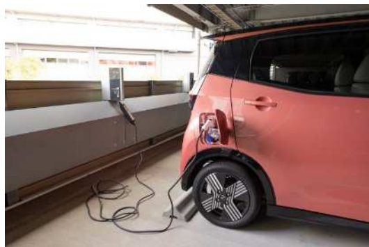
マンションにおける充電設備
