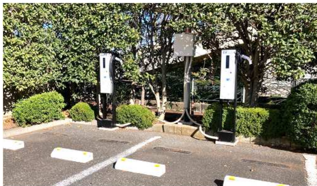
公共用のEV用充電設備 (川崎市男女共同参画センター)
