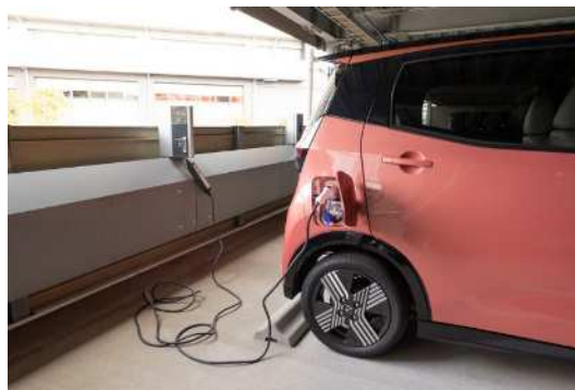
マンションにおける充電設備
