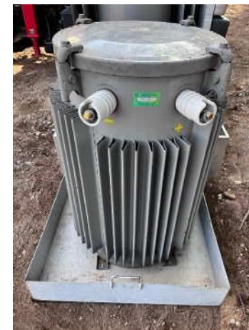
PCB廃棄物（変圧器）
