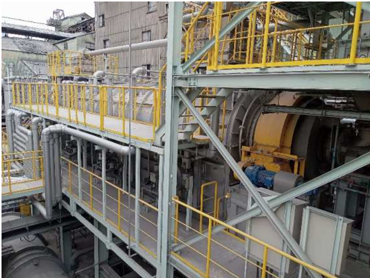
脆化リサイクル施設
