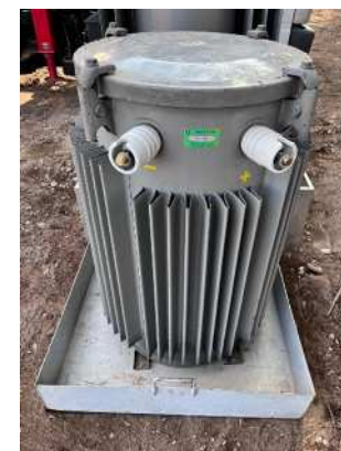
PCB廃棄物（変圧器）
