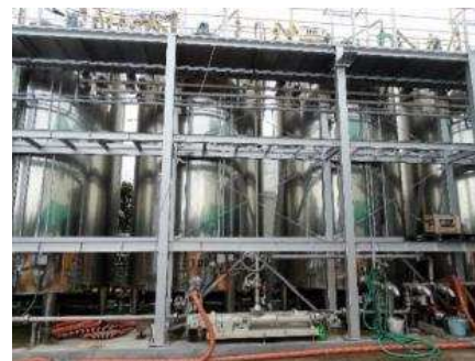
冷却保管タンク
