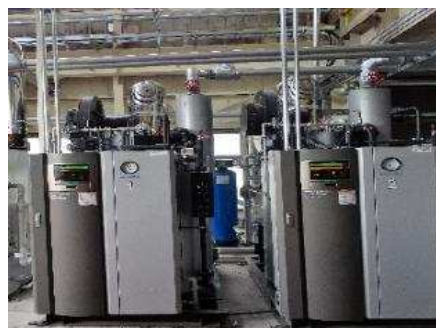
貫流蒸気ボイラー
