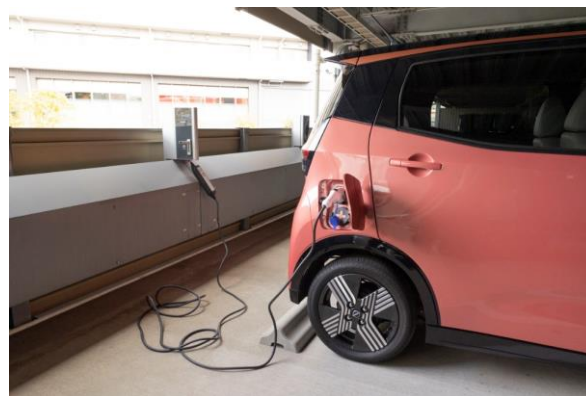
マンションにおける充電設備
