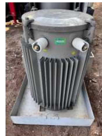
PCB廃棄物（変圧器）
