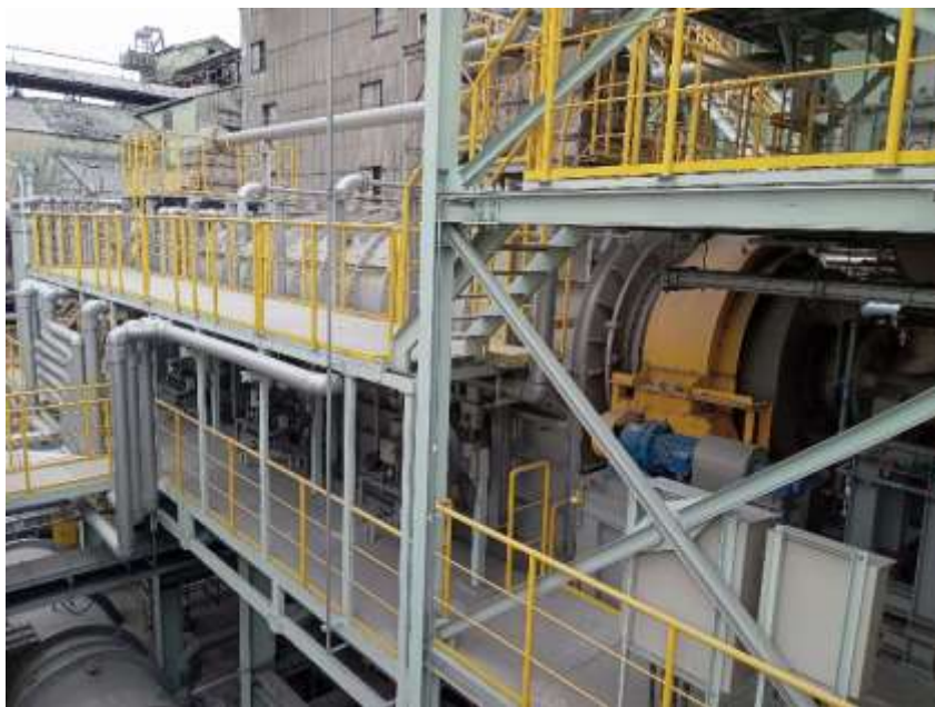
脆化リサイクル施設
