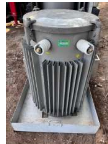
PCB廃棄物（変圧器）
