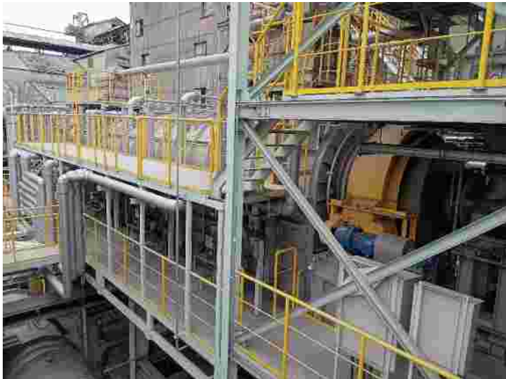
脆化リサイクル施設
