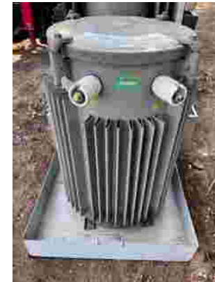
PCB廃棄物（変圧器）
