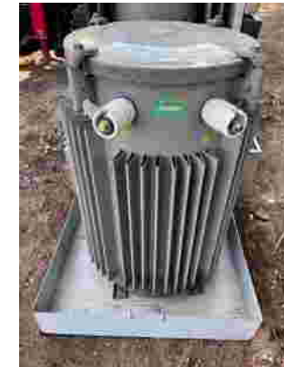
PCB廃棄物（変圧器）
