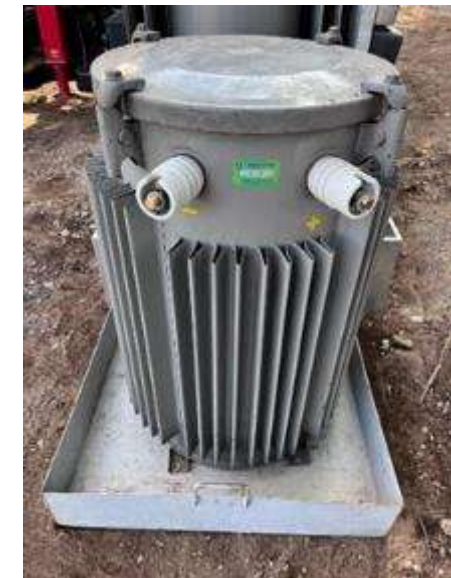
PCB廃棄物（変圧器）
