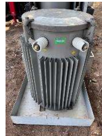
PCB廃棄物（変圧器）
