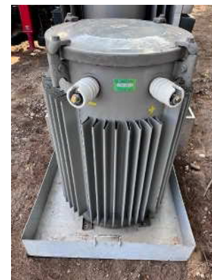
PCB廃棄物（変圧器）
