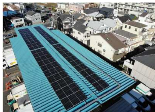
ヤマト運輸【太陽光発電設備】
