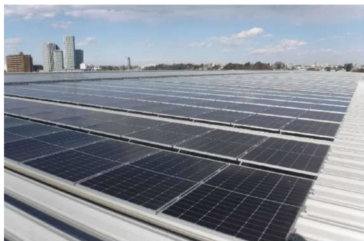
アマゾンジャパン【太陽光発電設備】
