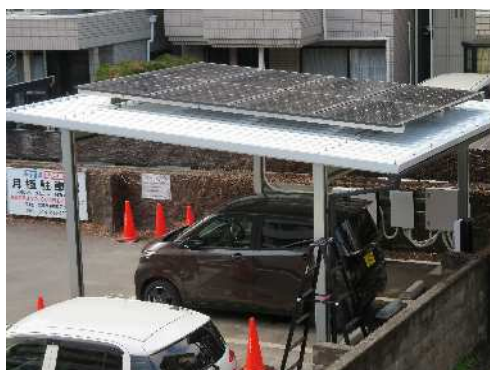
川崎信用金庫【ソーラーカーポート】
