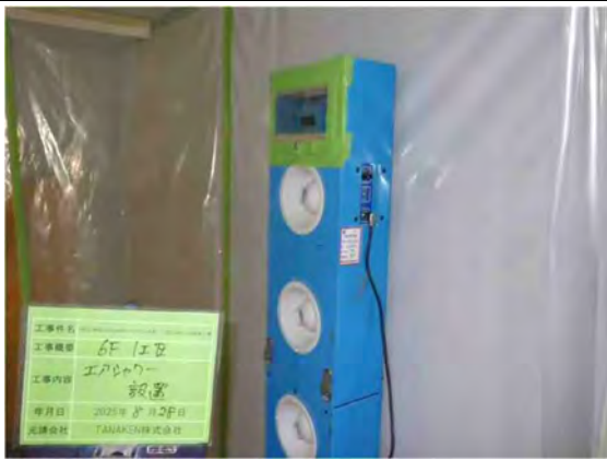
写真5. エアシャワー使用状況
