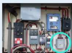
低圧分電盤内の低圧コンデンサー
