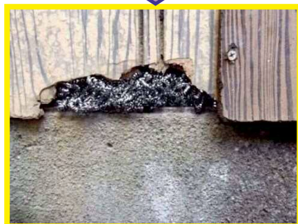
外壁の破損箇所に 金タワシを詰める
