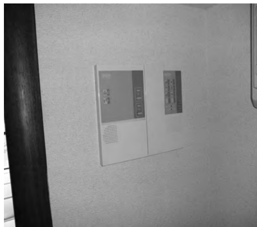
<緊急通報システム>
