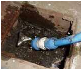
▲ 水の溜まった埋設型散水栓
