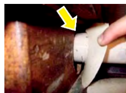
配管のすき間
