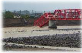
令和元年東日本台風 千曲川鉄橋崩落
