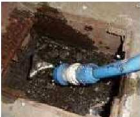
▲ 水の溜まった埋設型散水栓
