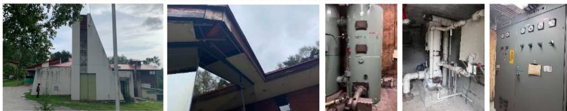
躯体の劣化が著しいエネルギー棟
