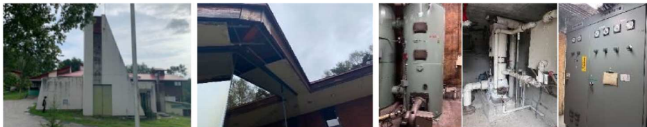
躯体の劣化が著しいエネルギー棟 渡り廊下軒裏の破損 ボイラー 消火設備 受変電設備 (耐用年数を超えた設備)
