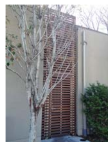
屋外設備の修景（商業施設）
