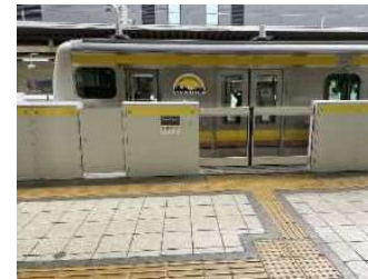
JR 南武線武蔵小杉駅ホームドア
