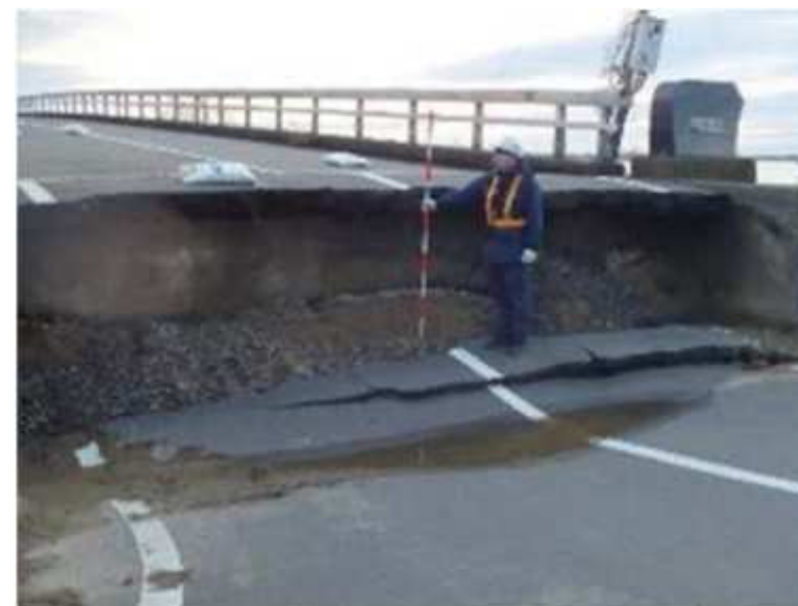
図 能登地震での橋りょうの被災状況 (出典)国土交通省資料
